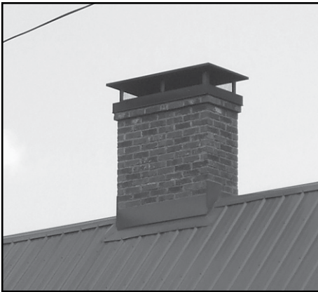
Metal Chimney Cap
